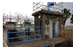
分水ゲートの監視・制御
