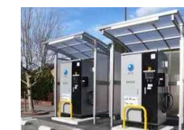
EVバス充電設備
